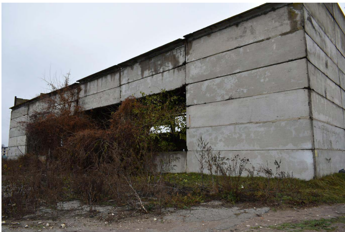
Figura nr. 3.11. Clădire degradată și abandonată (cartierul Sud)
