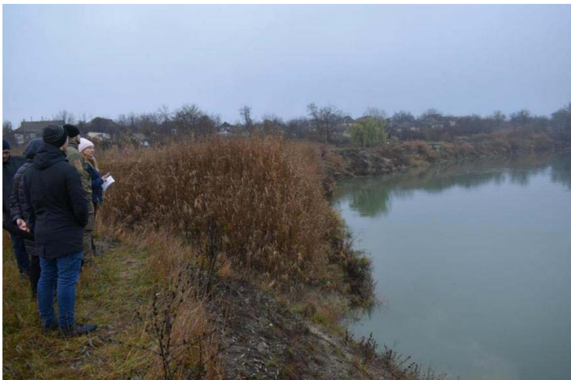
Figura nr. 3.5. Malurile râului Prut, care au nevoie de consolidare și întărire
