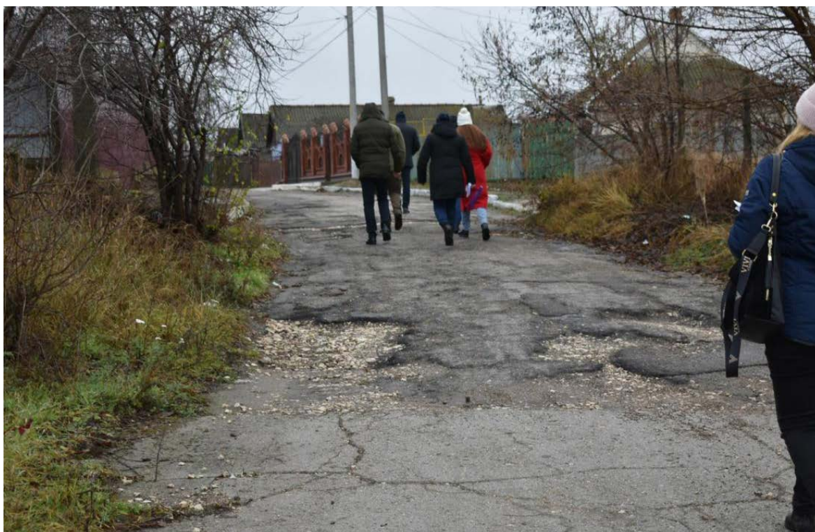
Figura nr. 3.9. Drumuri de foarte proastă calitate în zona de revitalizare (cartierul Sud)
