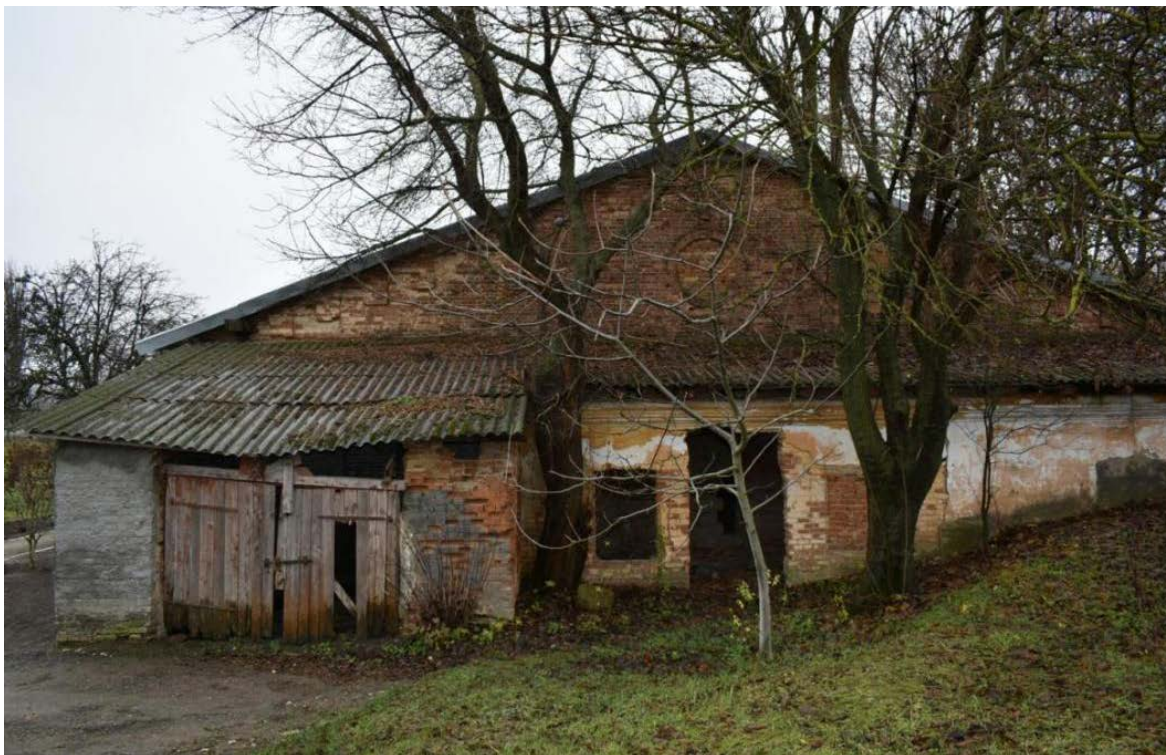
Figura nr. 3.4. Clădire degradată de pe teritoriul Centrului Tănărului Naturalist, care poate fi folosită pentru dezvoltarea turismului
